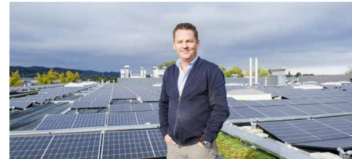
Franz Zwick, Geschäftsführer der Trunz Metalltechnik AG, zwischen den neu installierten Solar-Panels der Trunz Holding AG. /lg
