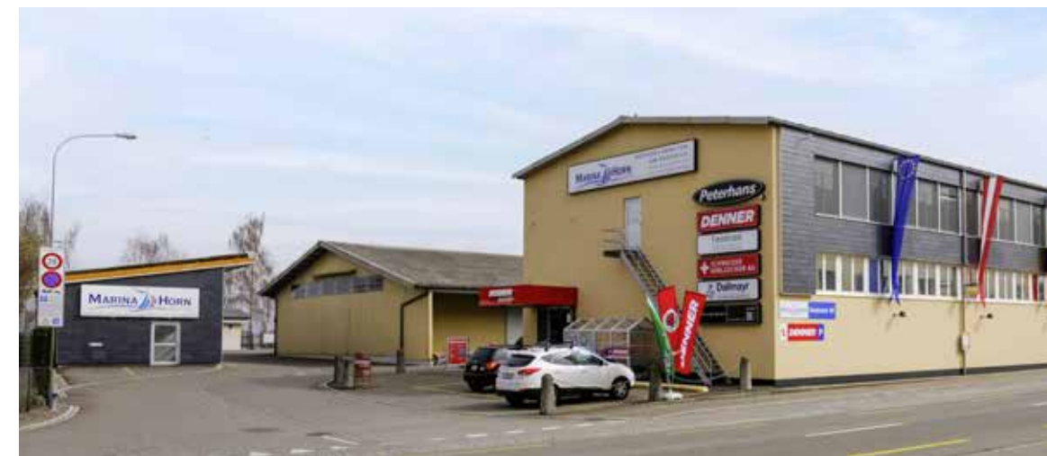
Im Zuge der Altlastensanierung auf dem ehemaligen Raduner-Areal werden unter anderem das «Marina Horn»-Gebäude (links im Bild) sowie die Liegenschaft hinter dem «Denner» abgebrochen.
