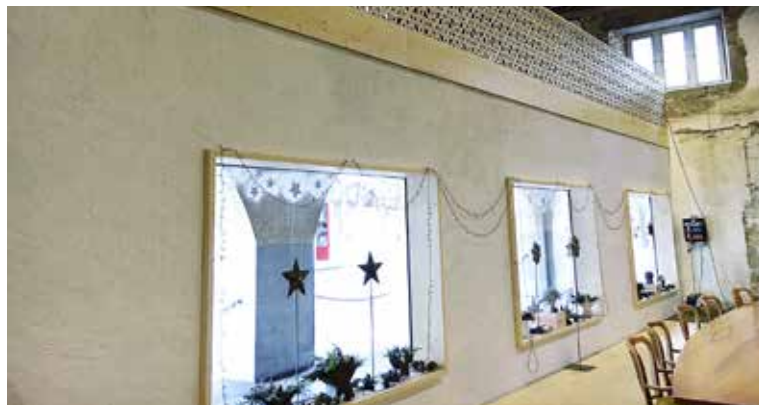
Blick in das «Kappeli»: Ein Holzgeländer wurde installiert und die Glasfronten eingefasst.
