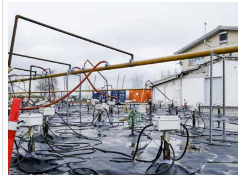
Die aufwändige Sanierung des Raduner Areals braucht Unmengen an Strom. lg
