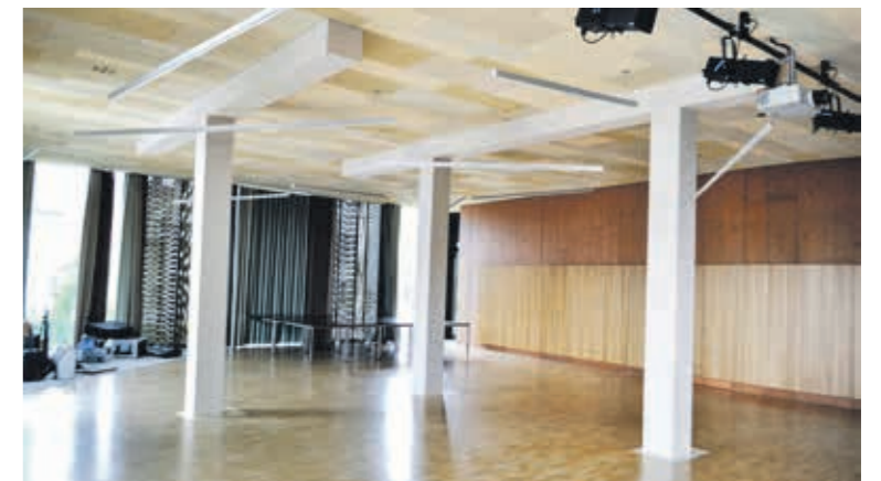
Näf & Partner patzte beim Sekundarschulhaus Reben 25: Die Decke der Aula des 2012 fertiggestellten Ergänzungsbaus muss heute gestützt werden (Bild), der Schadenfall wird von einem Ingenieurbüro aus Winterthur untersucht.
