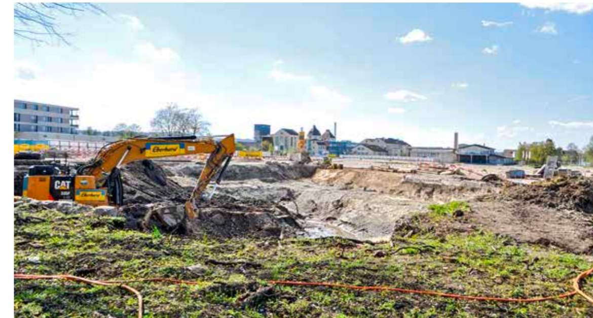
Das Radunerareal am Horner Seeufer wie es sich heute präsentiert: Die Altlastensanierung steht vor dem Abschluss.
