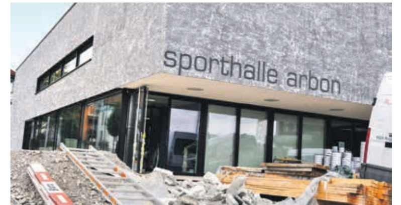
Näf & Partner patzte zweimal bei der 2015 fertiggestellten Sporthalle: Zuerst wölbte sich der zu schwach berechnete Hallenboden, dann wurde die Betonplatte über dem Untergeschoss viel zu schwach gebaut.
