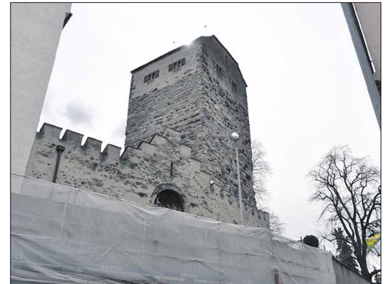
Die bröckelnde Arboner Schlossmauer ist bereits eingekleidet. Nach Ostern wird mit der Sanierung begonnen.
