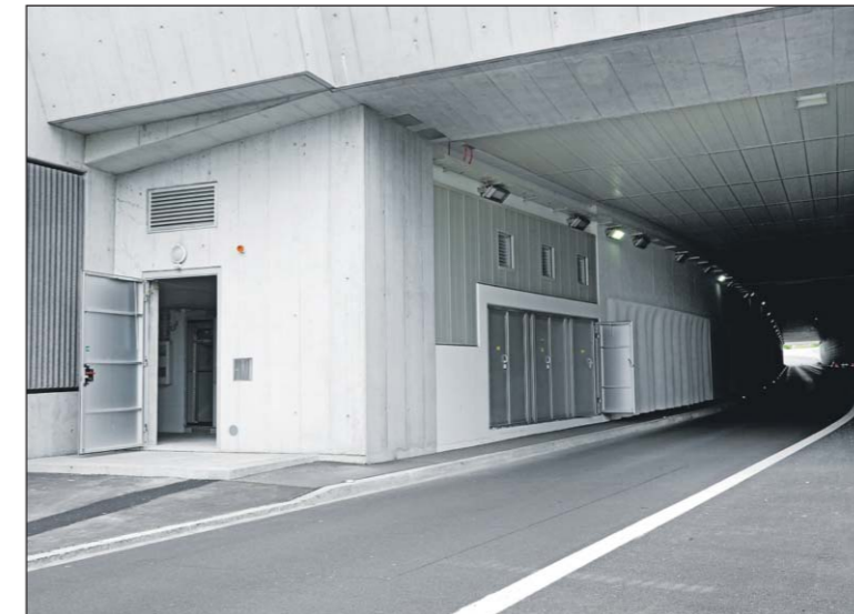
Zu den Neubauten gehört auch diese Trafostation beim Rosengartentunnel an der «Neuen Linienführung Kantonsstrasse». Bild: Martin Sinzig
