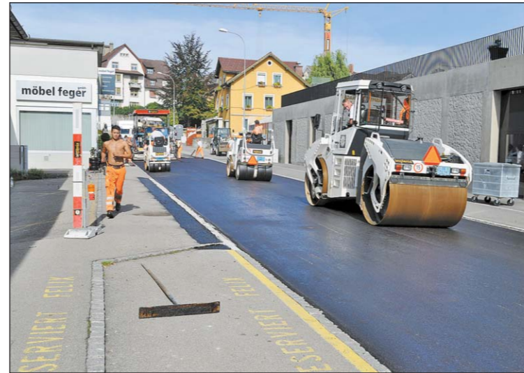
Belagseinbau an der Arboner Rebhaldenstrasse – das Resultat ist eine vorübergehende «Autobahn» und damit eine «Einladung» zum Rasen...
