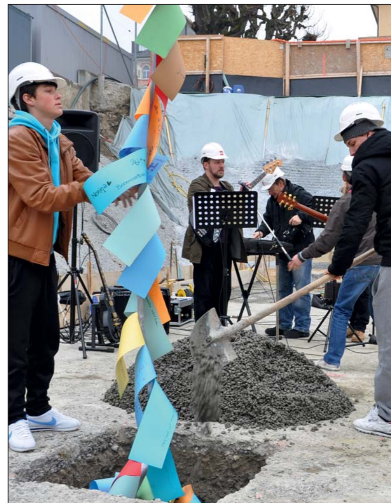
Vom Kran herab schweben die Wunschbänder, welche im Ergänzungsbau Reben 25 zusammen mit den wichtigsten Dokumenten (Kreditbotschaft, Flyer, Abstimmungsergebnisse) von zwei Schülern «einbetoniert» werden.
