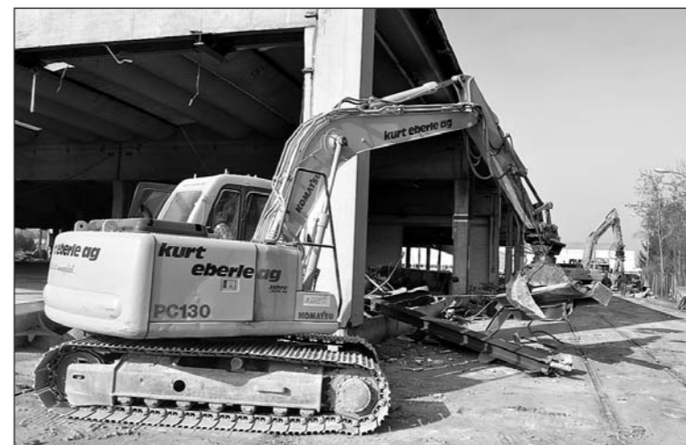
Eine Steinacher Industriehalle verschwindet und macht 36 neuen Wohnbauten Platz. Die 1965 von Saurer erstellte und später von der AFG genutzte Schöntalhalle kann den schweren Baumaschinen nicht trotzen.
