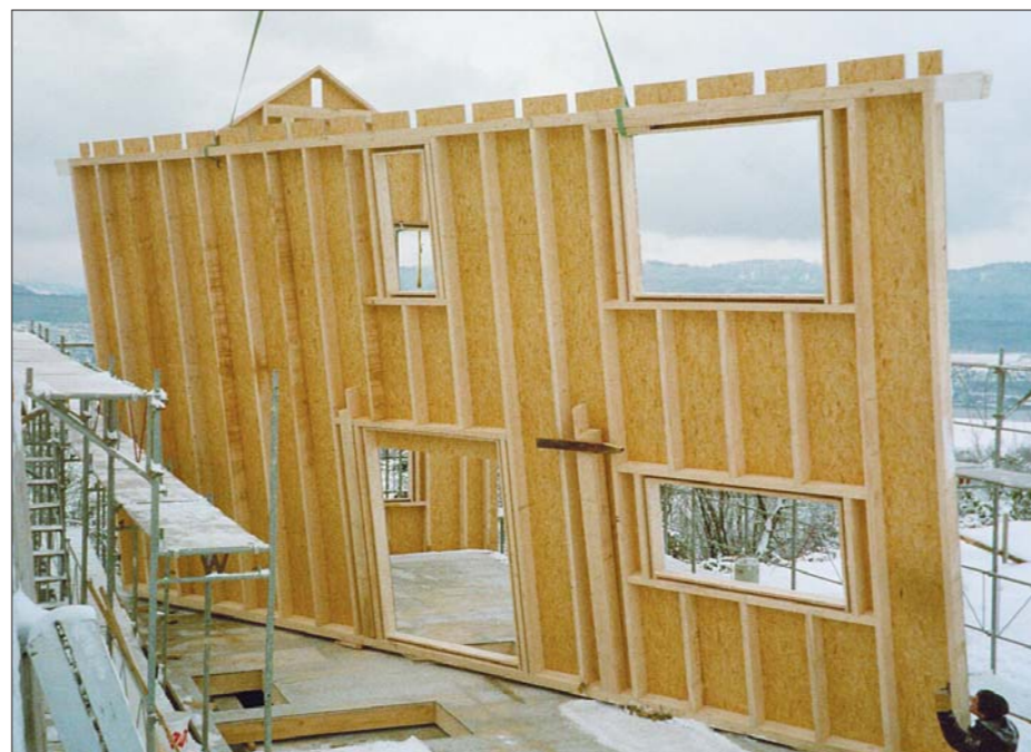
Der grosse Vorteil der Holzelement-Bauweise von Fecker Holzbau liegt neben dem ökologischen Aspekt auch im behaglichen Wohngefühl.
